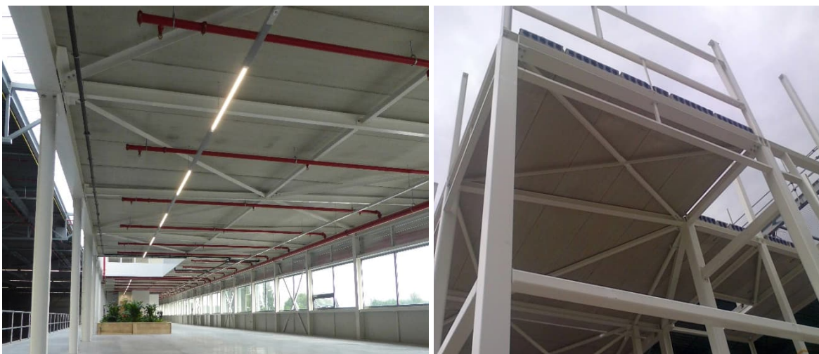
Fig. 4.17 Sistem demontabil de planșeu folosind elemente prefabricate și contravânturi în planul planșeului [29]
