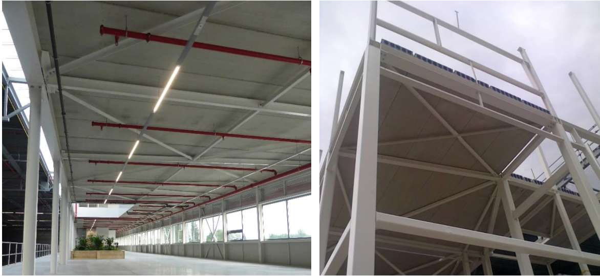
Fig. 4.17 Système de plancher démontable utilisant des éléments préfabriqués et un contreventement de plancher [29]
