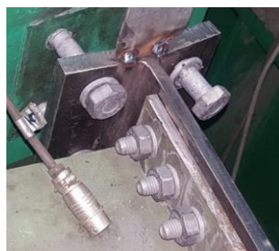
Фигура 5.13 - Съединение след разрушение: фланцеви Т-профил
