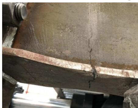
г) Разрушение в средата на RBS 1C
